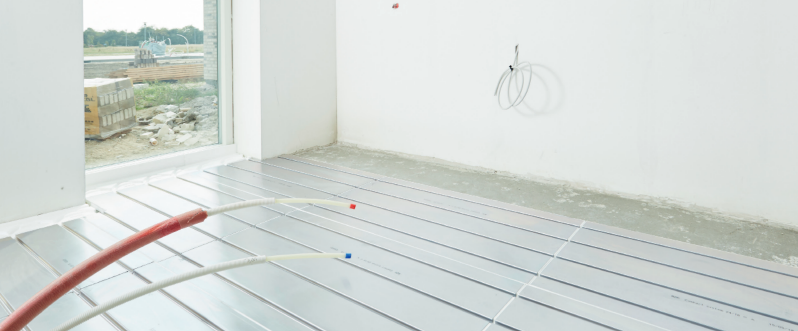
Dele af det 200 m 2 store hus er udført med Roth Compactsystem, og resten er udført traditionelt med nedstøbe rør i beton
