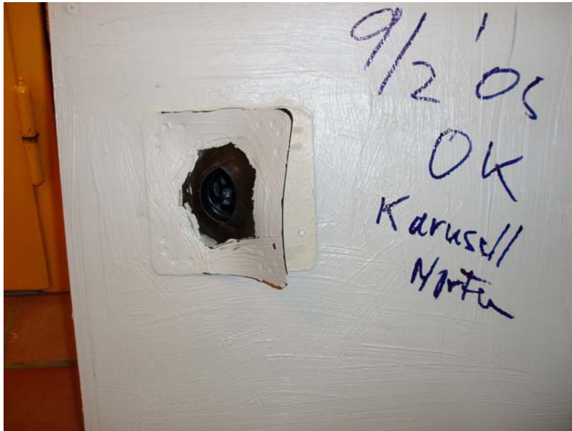
Bøkgjennomføring med mansjett etter test
